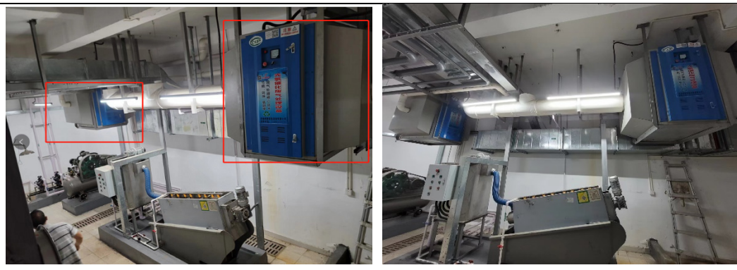
图5 污水处理站废气治理设备照片
